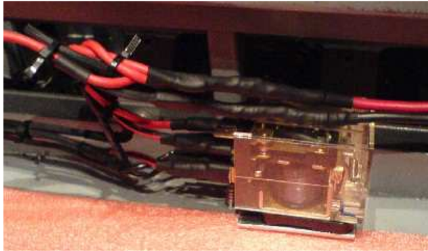
Abb. Schaltrelais zur Sicherheits- und Stromschaltung im Fahrgestell.
